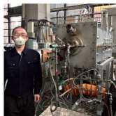
アンモニア燃焼炉
